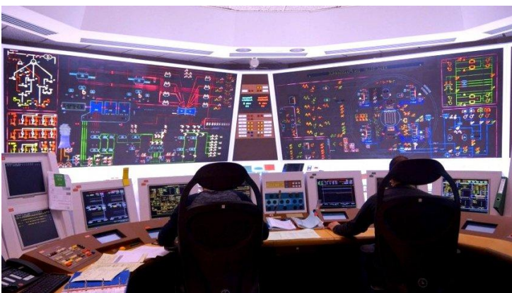
Salle de Contrôle de la Centrale de Civaux © EDF
